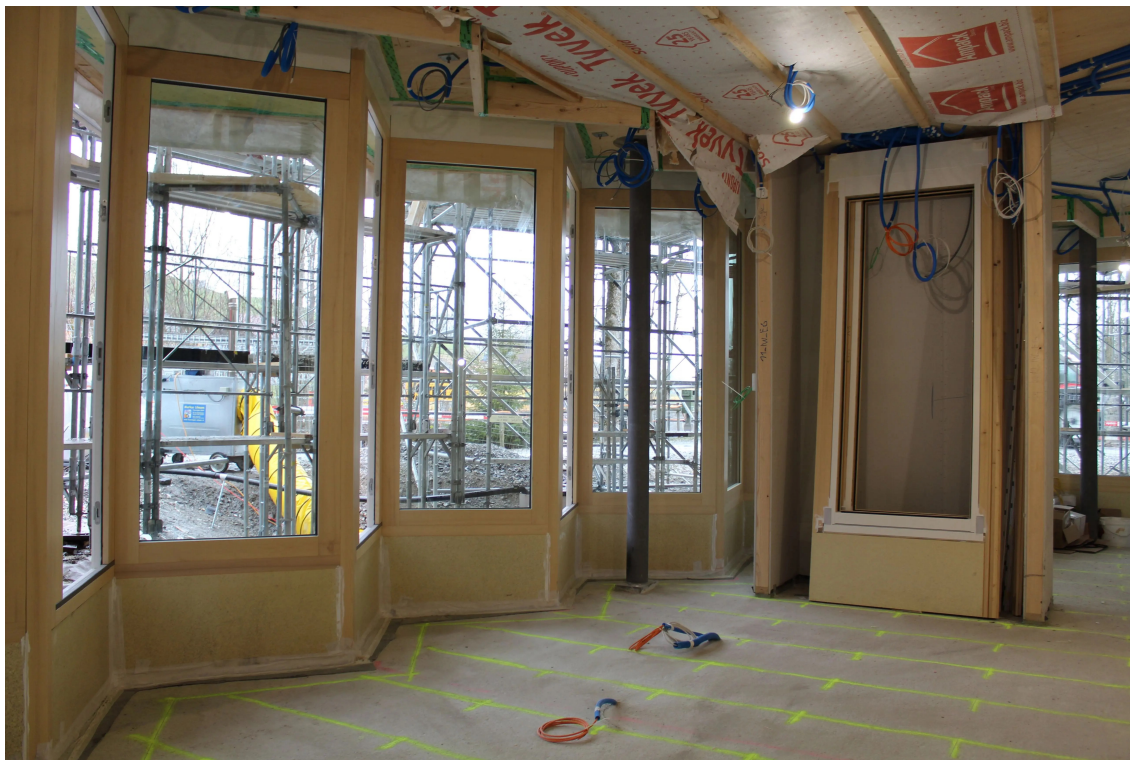
Durch das Badehaus zieht gegenwärtig noch der Wind. Bild: ssd
