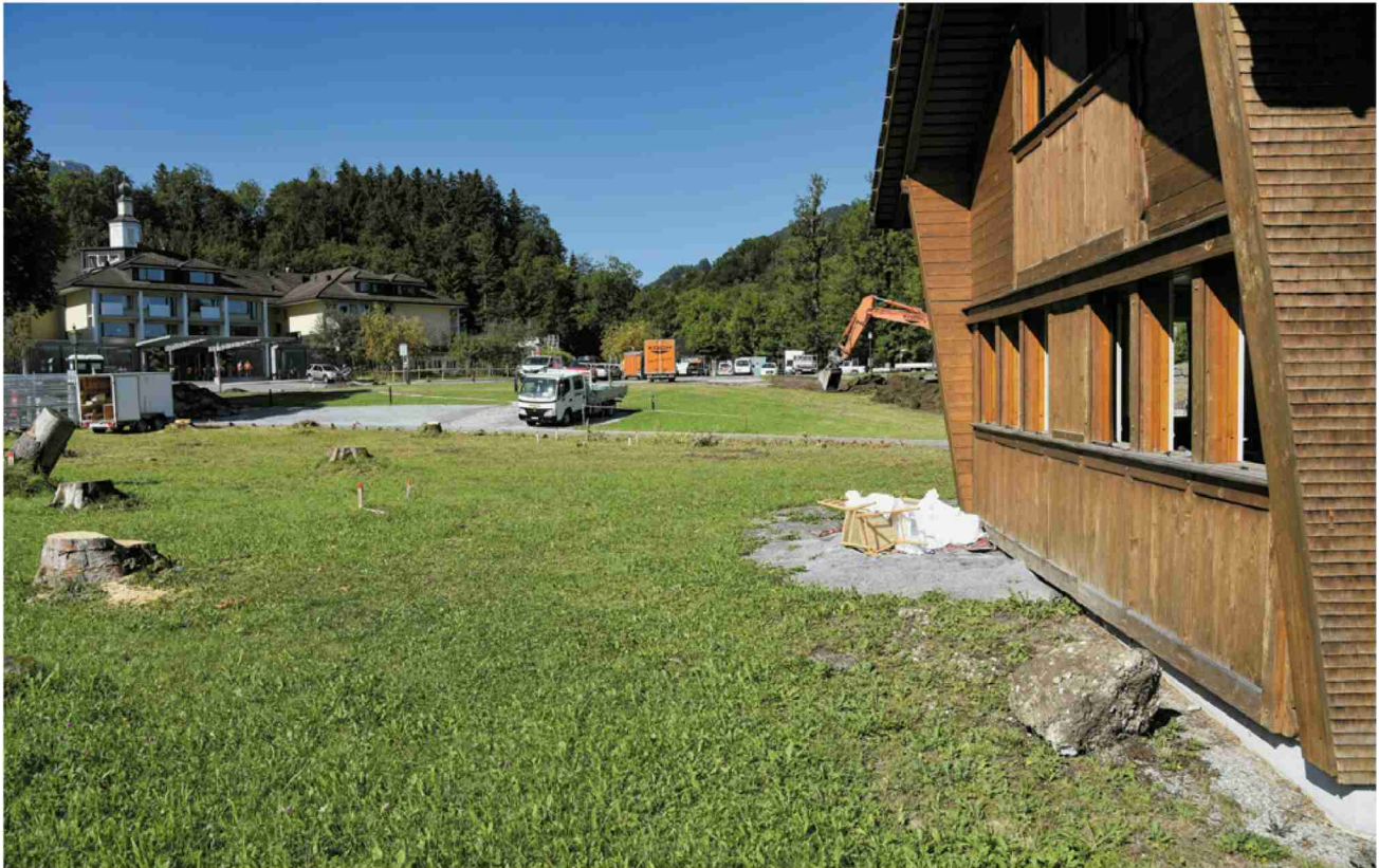
Das vor sechs Jahrzehnten erbaute Haus Potthoff (rechts) wird diese Woche rückgebaut. Auf dem Areal entsteht der neue Seminarpark. (Bild: H9)
